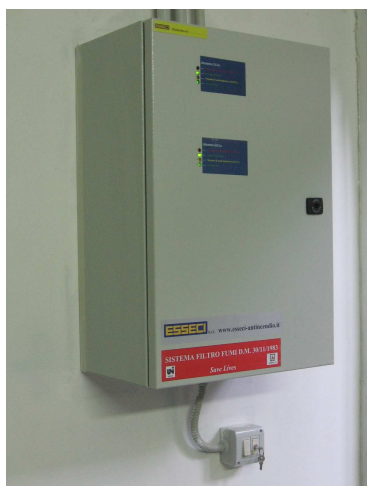
Foto 01- Quadro di Comando
