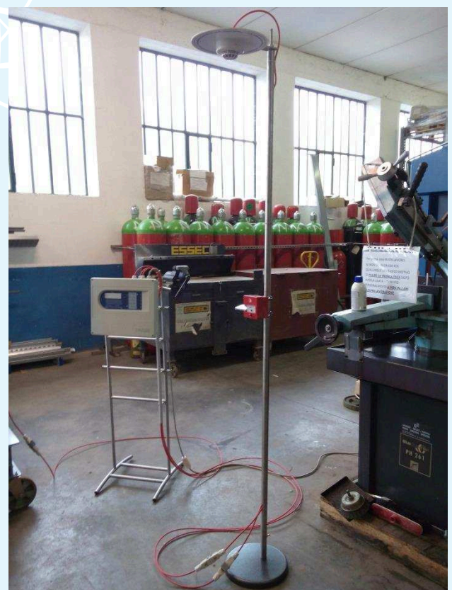
Fotografia del sistema di rilevamento automatico di incendio e del pulsante di allarme collegati alla centrale di rilevamento incendi del dispositivo.
